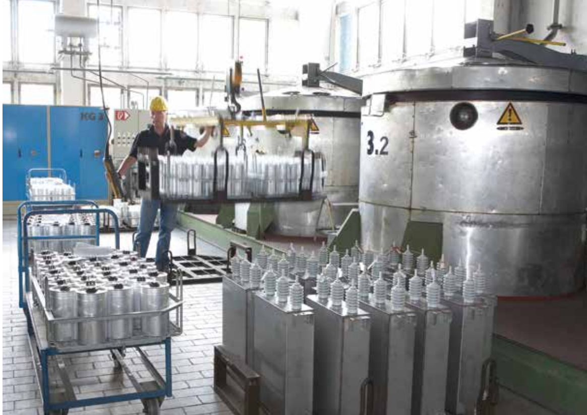
Alte Kessel mit neuer Funktion: Die noch aus den 70er Jahren stammenden Imprägnierkessel wurden, generalüberholt und mit neuer Steuerung ausgestattet, zu Vakuum-Trockenkesseln umfunktioniert.
